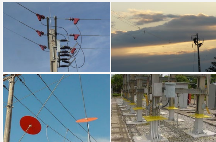
Απομόνωση πόλου για την αποφυγή ηλεκτροπληξίας και τύπος κορδέλας FBF για την αποφυγή προσκρούσεων που είναι εγκατεστημένες στη γραμμή ισχύος στην Πορτογαλία Πηγή: © EDP Renewables
